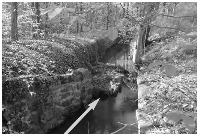
stark hinterspülte und teilweise bereits eingestürzte Stützwand
