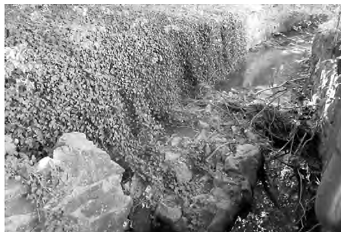
die eingestürzte Stützwand stellt ein großes Abflusshindernis für den Gewässerverlauf dar
