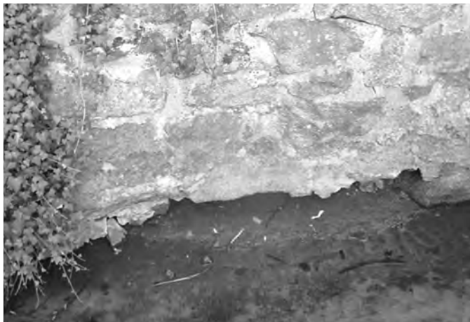
geschädigter unmittelbar angrenzender Ufermauerteil an den bereits zerstörten Teil
