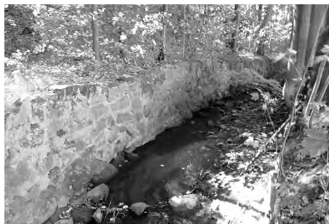
beginnende Unterspülung der Ufermauer angrenzend Oberstrom
